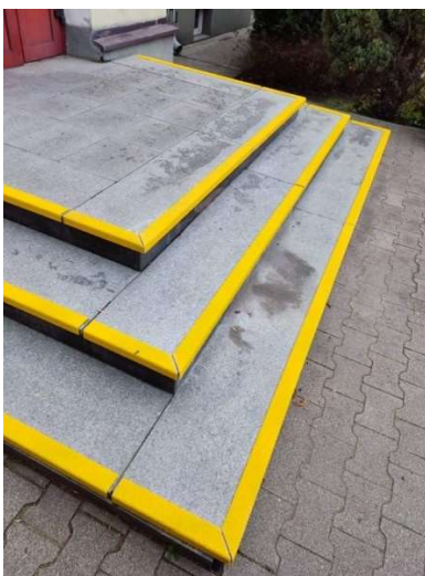
Krawędź stopni zabezpieczona nakładką antypoślizgową w kontrastowym żółtym kolorze.
